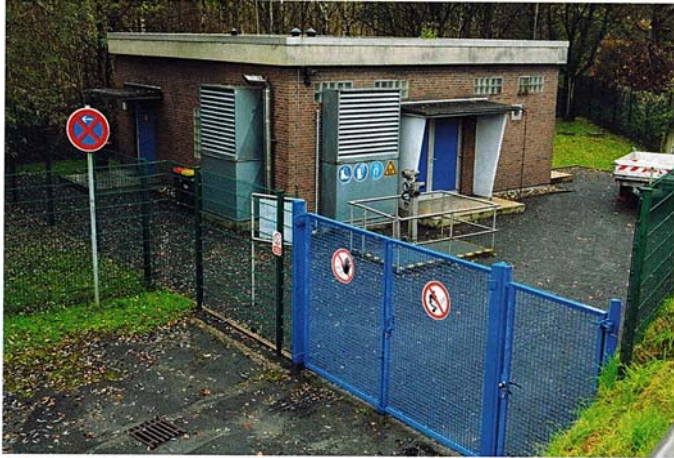
Das Pumpwerk Frydagstraße ist eines der 18 Pumpwerke, die das Lünener Stadtgebiet bei jeder Wetterlage sicher entwässern.
